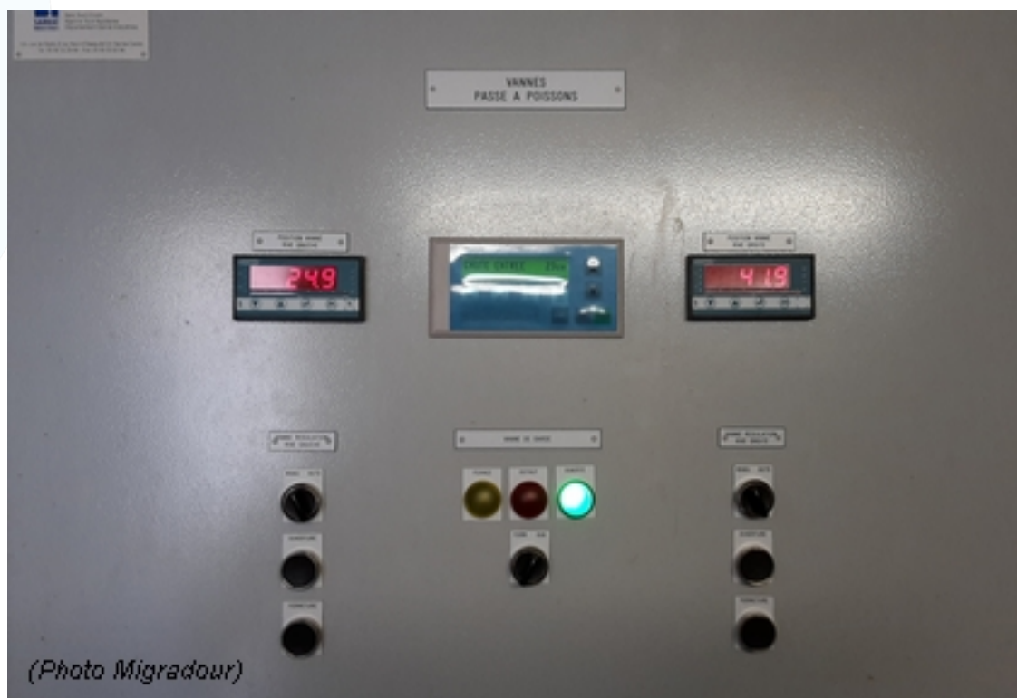
Figure 6 : Automate d'ouverture des vannes aval de la passe à poissons
